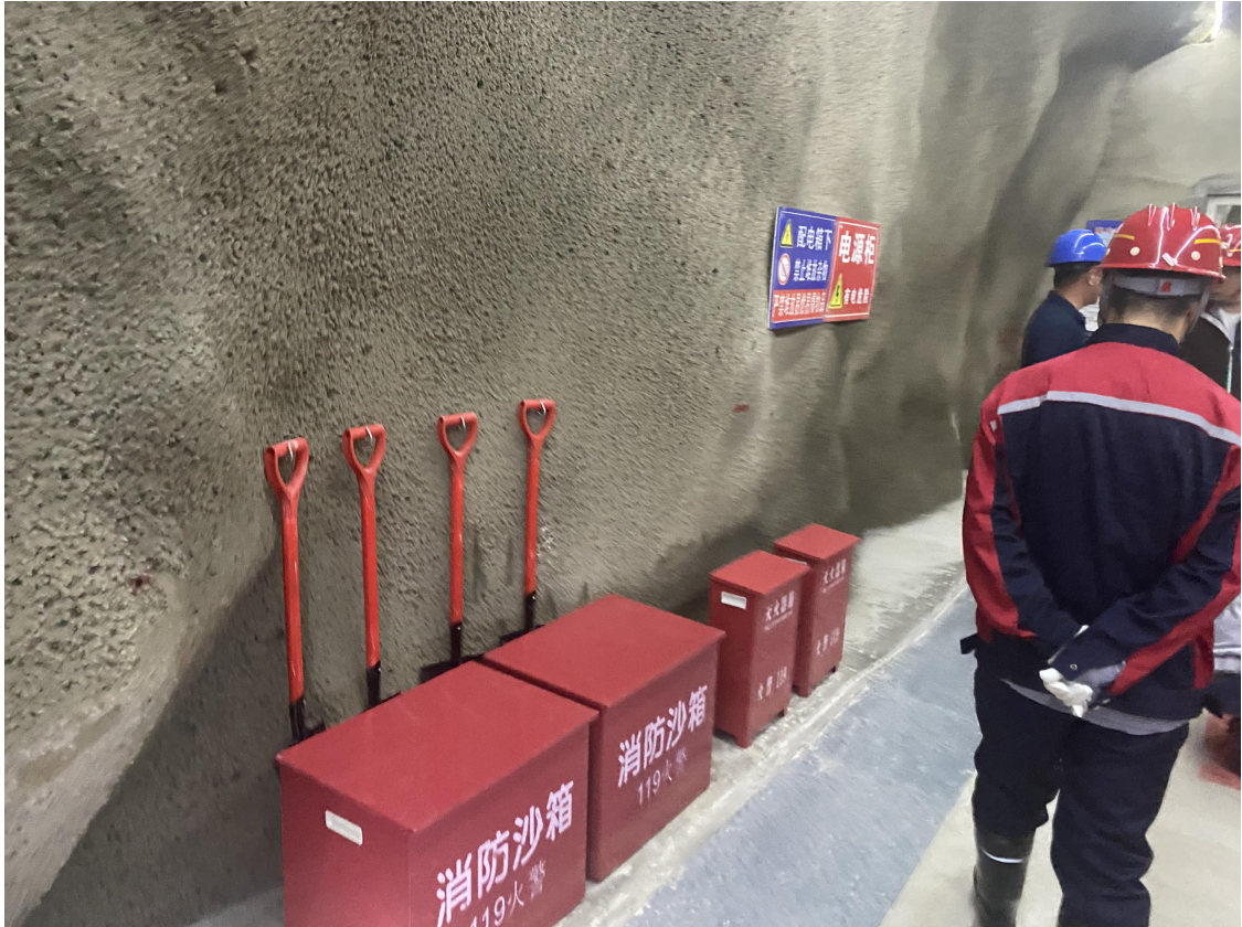
图 2-16 井下消防安全设施
