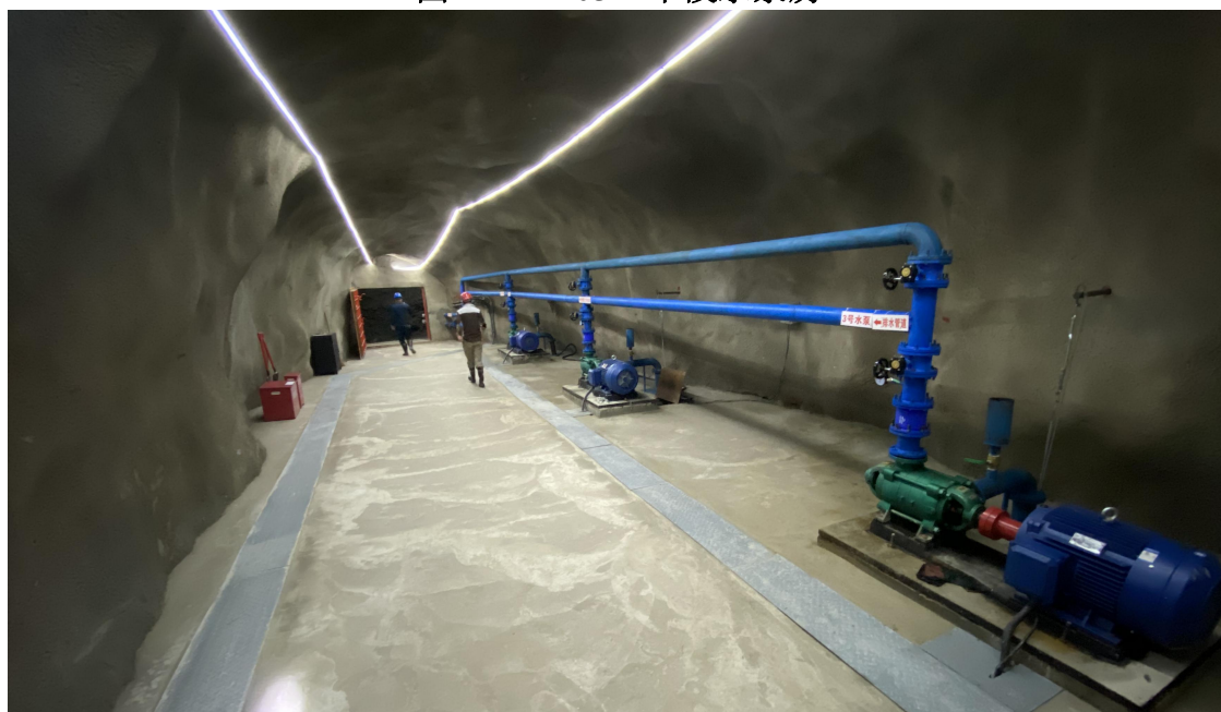
图 2-13 105m 中段水泵房
