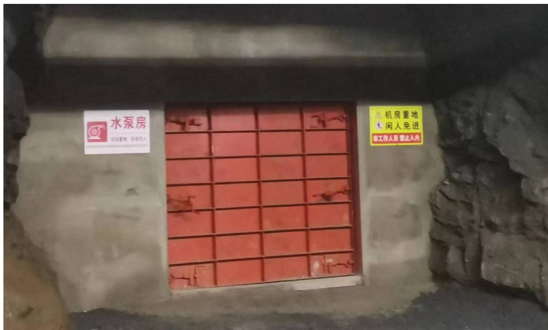
图 2-12 105m 中段水泵房
