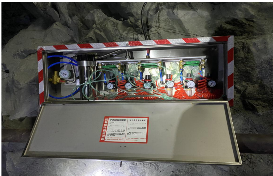
图 2-13 压风、供水自救装置
