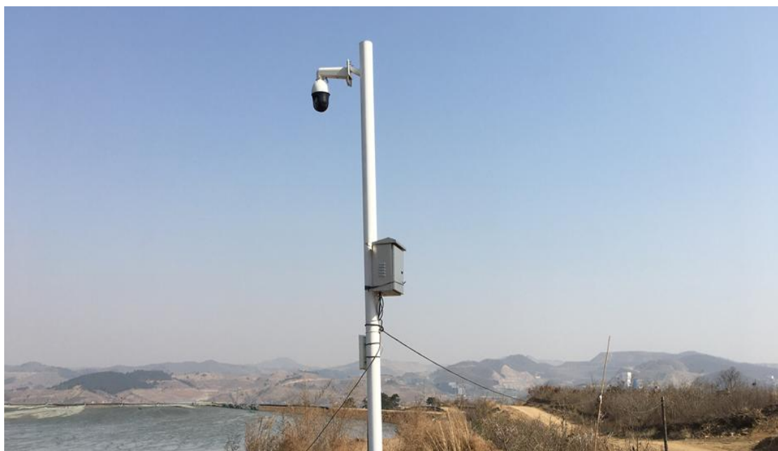
图 2-18 视频监控设施
