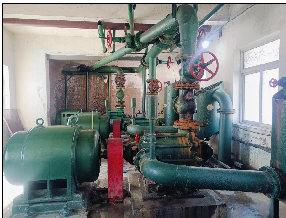
图 2-20 尾矿库水泵房
